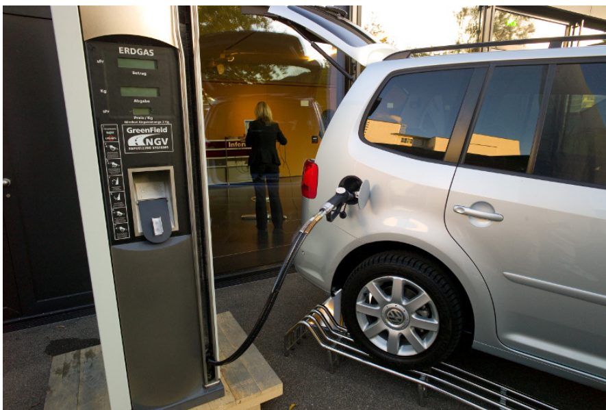
Die neue Generation der Erdgastankstellen soll in der Bedienung deutlich einfacher sein.
